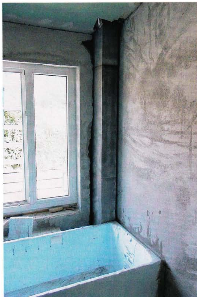
■ Rechtzeitig konnte der Mangel behoben werden. Später hätte der geflieste Schacht ggf. komplett aufgestemmt werden müssen, um an die Abgasleitung zu kommen. Mit der Systemlösung von Skobifix sind Brandschutz, Längendehnung, Demontierbarkeit, Gasdichtheit, Wärmeschutz und alle anderen Anforderungen erfüllt.
