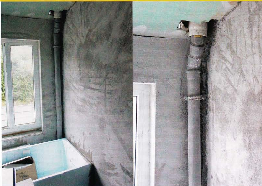
■ Die Abgasleitung wurde unmittelbar hinter einer Badewanne per Rohrschelle kraftschlüssig installiert. Dadurch ist eine einfache Demontierbarkeit nicht gegeben. Ohnehin wäre die „Brandschutzverkleidung“ nur zweiseitig erfolgt.
