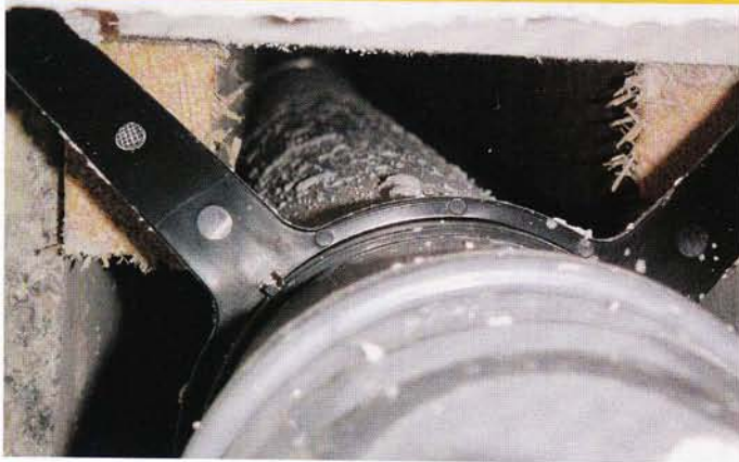
■ Bei diesem Schacht besteht die Trägerkonstruktion aus Holz. Auch ist die Abgasleitung kraftschlüssig mit der Schachtkonstruktion verbunden.
